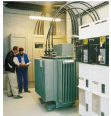
800 kVA - 20 kV / 400 V
